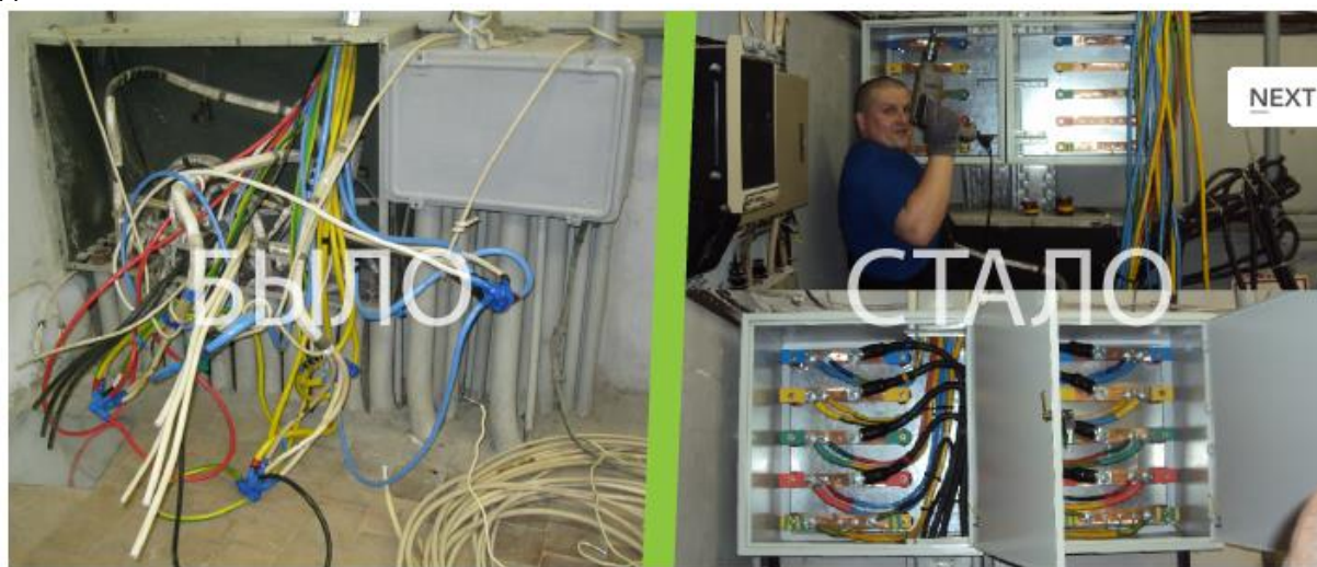
Электропитание чиллеров на 29 этаже здания в гостинице ВЕГА по адресу: Измайловское шоссе, д. 71, корп. 3В
