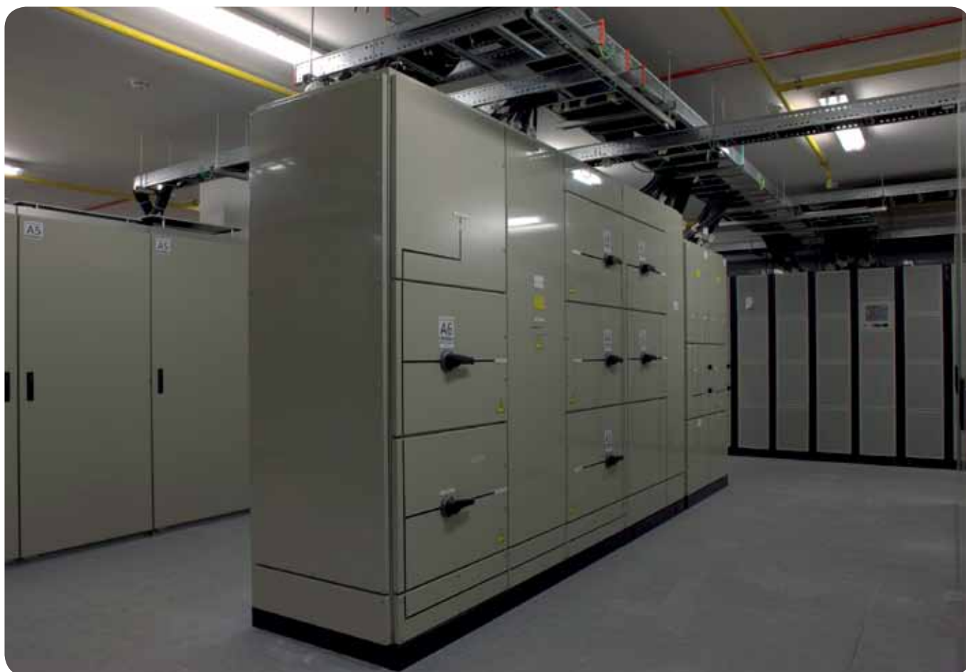
6 Инженерная инфраструктура для крупных дата-центров и ЦОДов с высокой энергетической плотностью
