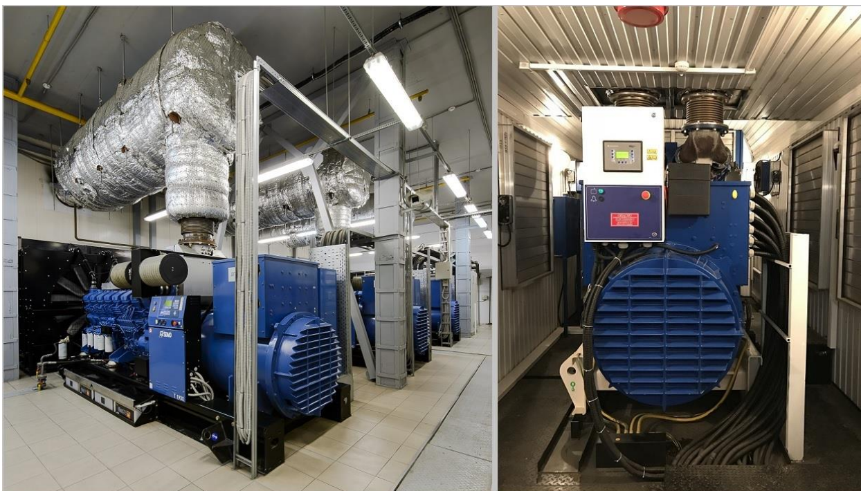
ДГУ в помещении и в контейнерном исполнении.
